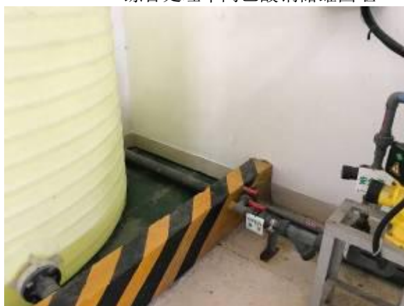
综合处理车间消毒间次氯酸钠围堰导流管
