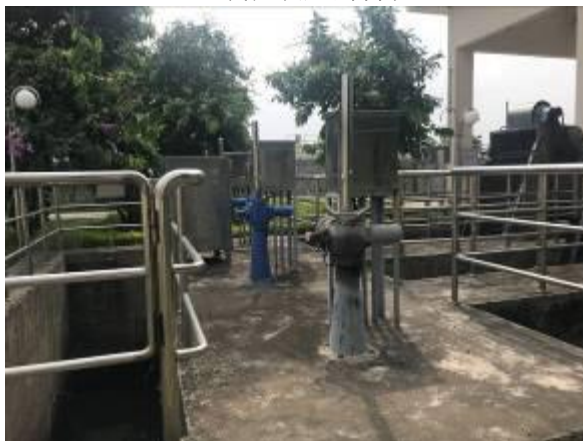
厂区污水进水闸门
