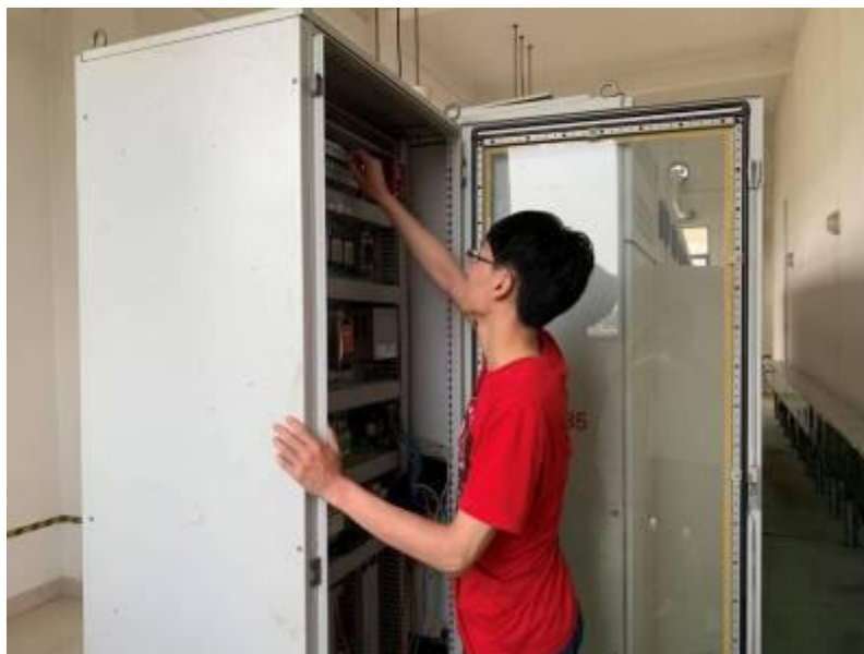
图 4 水处理配合调度将现场所有设备退出运行状态
