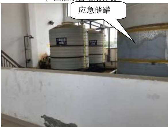
三氯化铁储罐围堰及应急储罐
