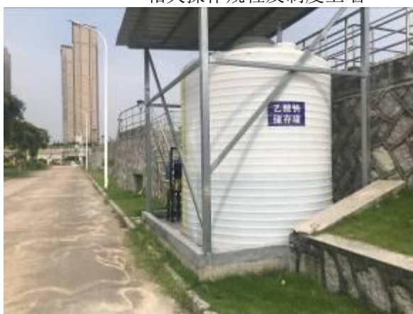
一期氧化沟旁乙酸钠储罐围堰
