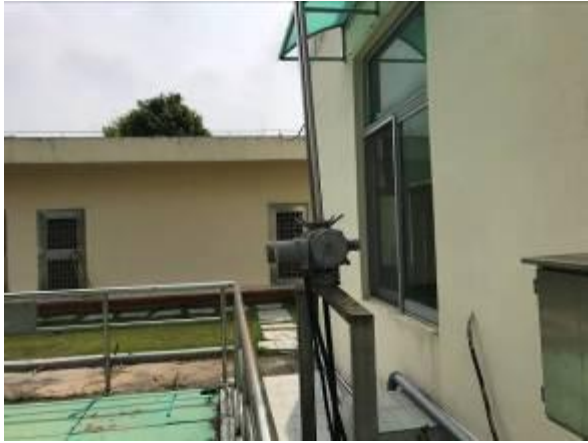
厂区污水排放口闸门
