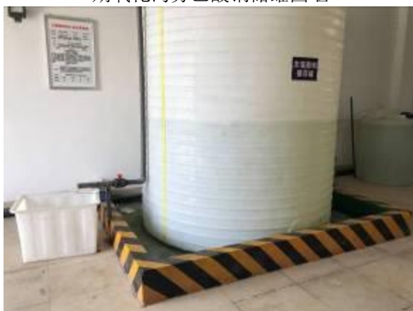
综合处理车间消毒间次氯酸钠围堰
