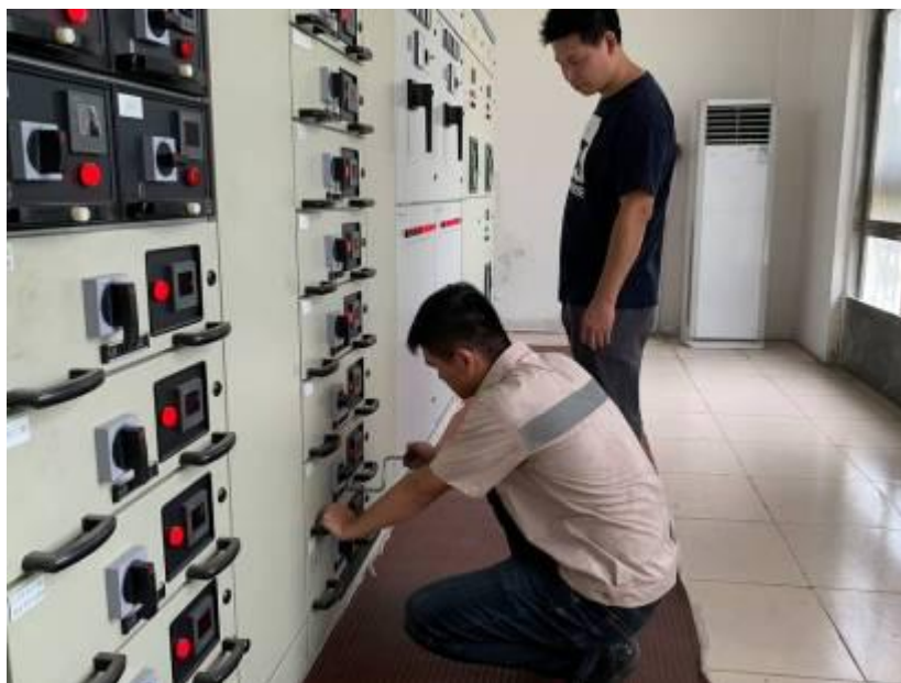
图 5 机修电工人员检查低配间配电系统
