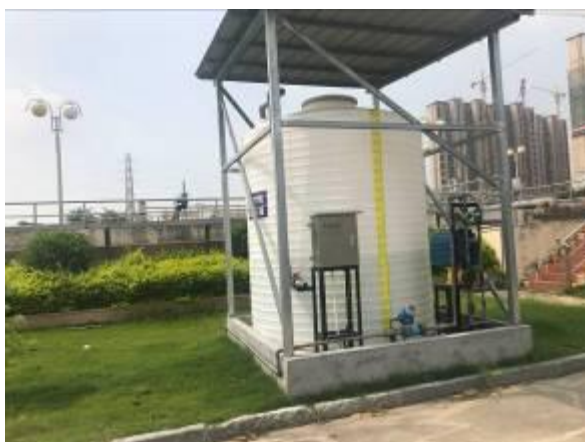
二期氧化沟旁乙酸钠储罐围堰
